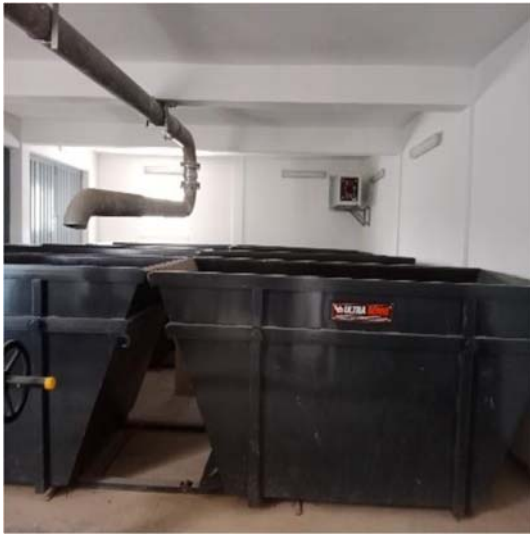
trémies de stockage des boues centrifugées
