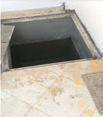
fosse de neutralisation des eaux de vidange
