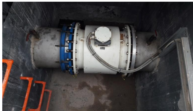
Figure 7 : Débitmètre électromagnétique pour eaux brutes monté sur la conduite DN 500
