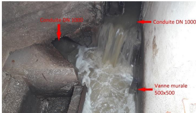
Figure 5 : Arrivée des deux collecteurs DN 1000 dans le DO
