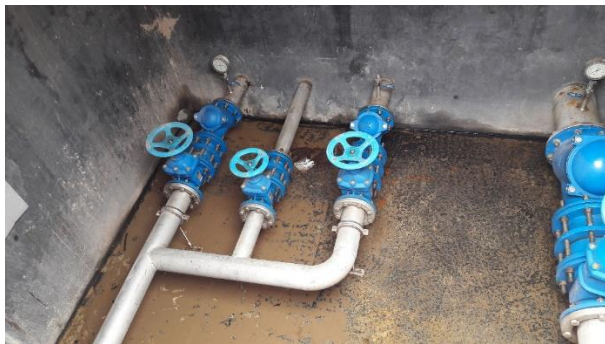
Figure 29 : Pompes d'extraction des boues en 1+1 (la ligne 2)
