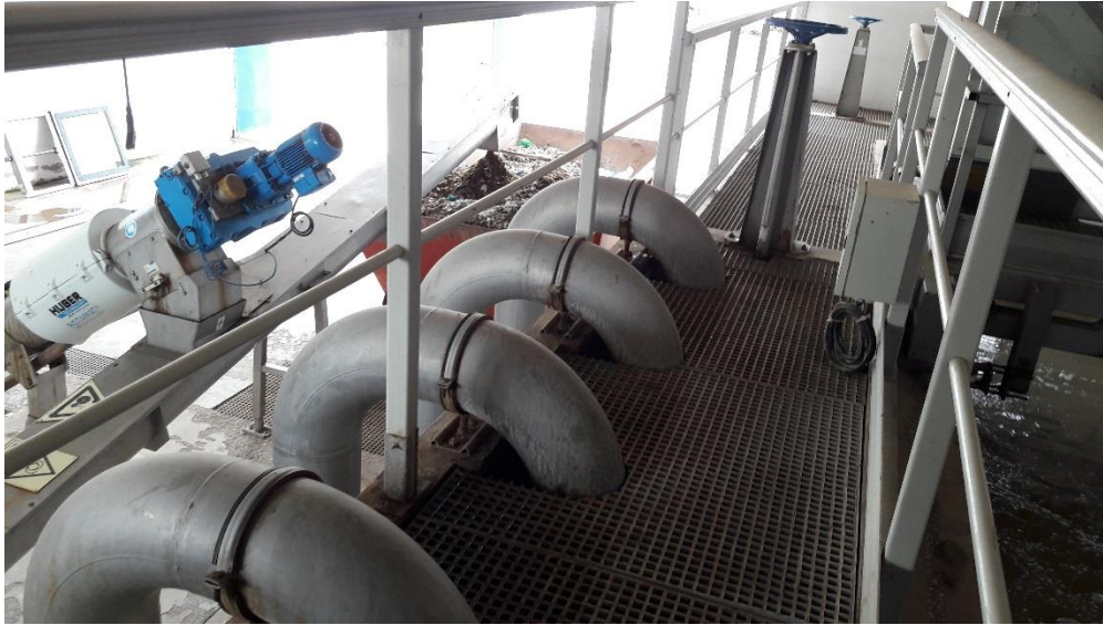
Figure 12 : Conduite de refoulement DN 200 des 4 pompes de relevage
