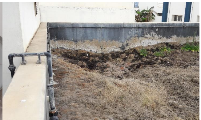
Figure 42 : Etat du matériau de garnissage du biofiltre
