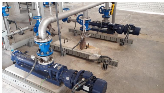
Figure 34 : Pompes d'extraction des boues épaissies
