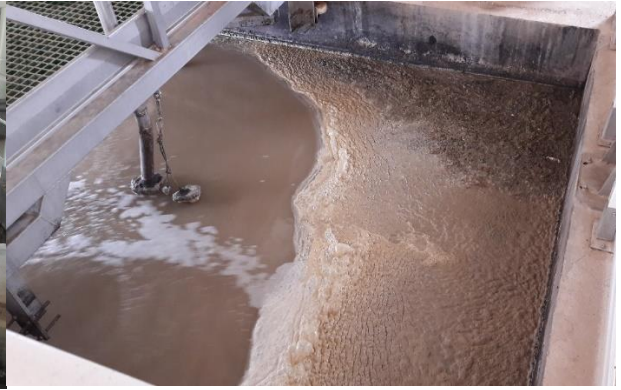
Figure 14 : Accumulation de produits flottants et graisseux en surface des dessableurs/déshuileurs
