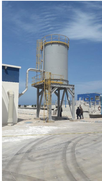
Figure 40. Silo de stockage de des boues déshydratées et chaulées
