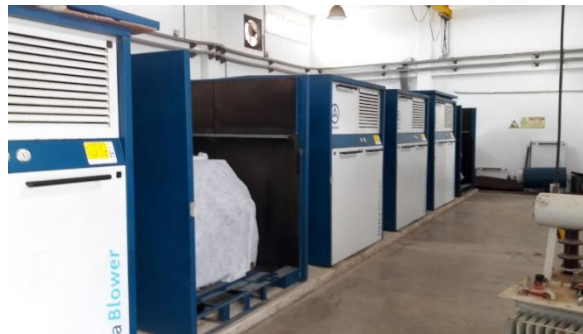
Figure 21 : Bâtiment des surpresseurs d'air pour les réacteurs biologiques ; les machines de secours sont déposées pour réparation
