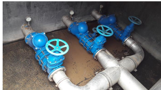
Figure 30 : Pompes de recirculation des boues en 2+1 (la ligne 2)
