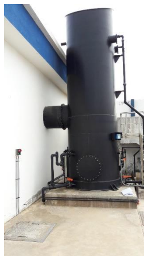
Figure 43 : Tour de lavage et d'humidification de l'air vicié
