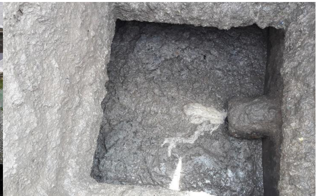
Figure 27 : Fosse de récupération des mousses et flottants du clarificateur
