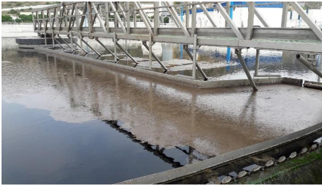
Figure 24 : Boues flottante au niveau du clarificateur de la ligne 2
