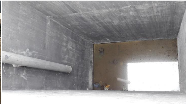
Figure 23 : Fosse prévue pour récupérer les mousses et flottants d'un dégazeur
