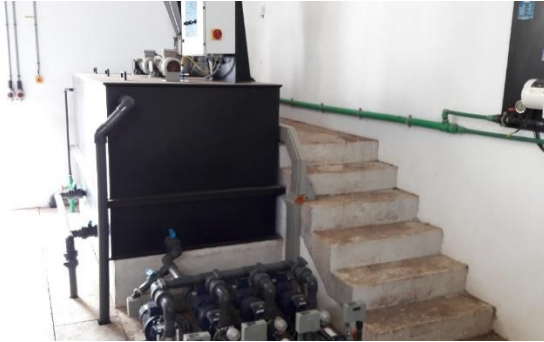
Figure 36 : L'unité de préparation du polymère
