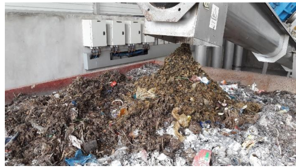
Figure 11 : Nature des refus de dégrillage et état de remplissage de la benne
