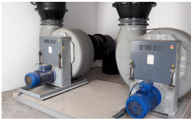
Figure 41 : Ventilateur de l'air vicié de 14 000 m 3 /h
