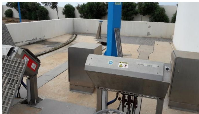
Figure 32 : Equipements du système de désinfection
