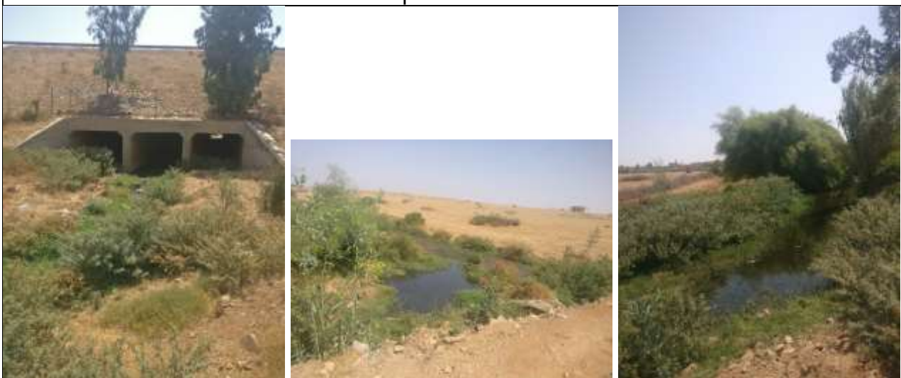
écoulement des eaux usées en aval du point de rejet actuel
