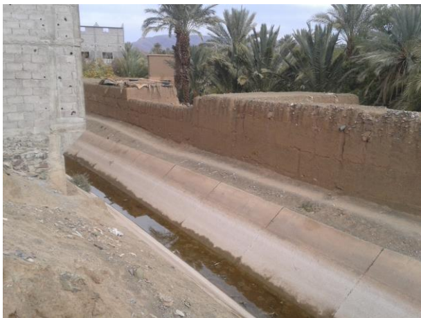
Photo N°1: Contrainte de passage des conduites
