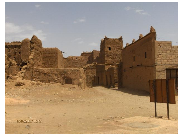
Photo N°3: Construction en pisé dégradé
