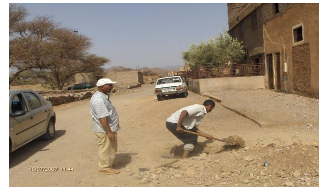
Photo N°3: Regard enterré au niveau du lotissement Ennakhil
