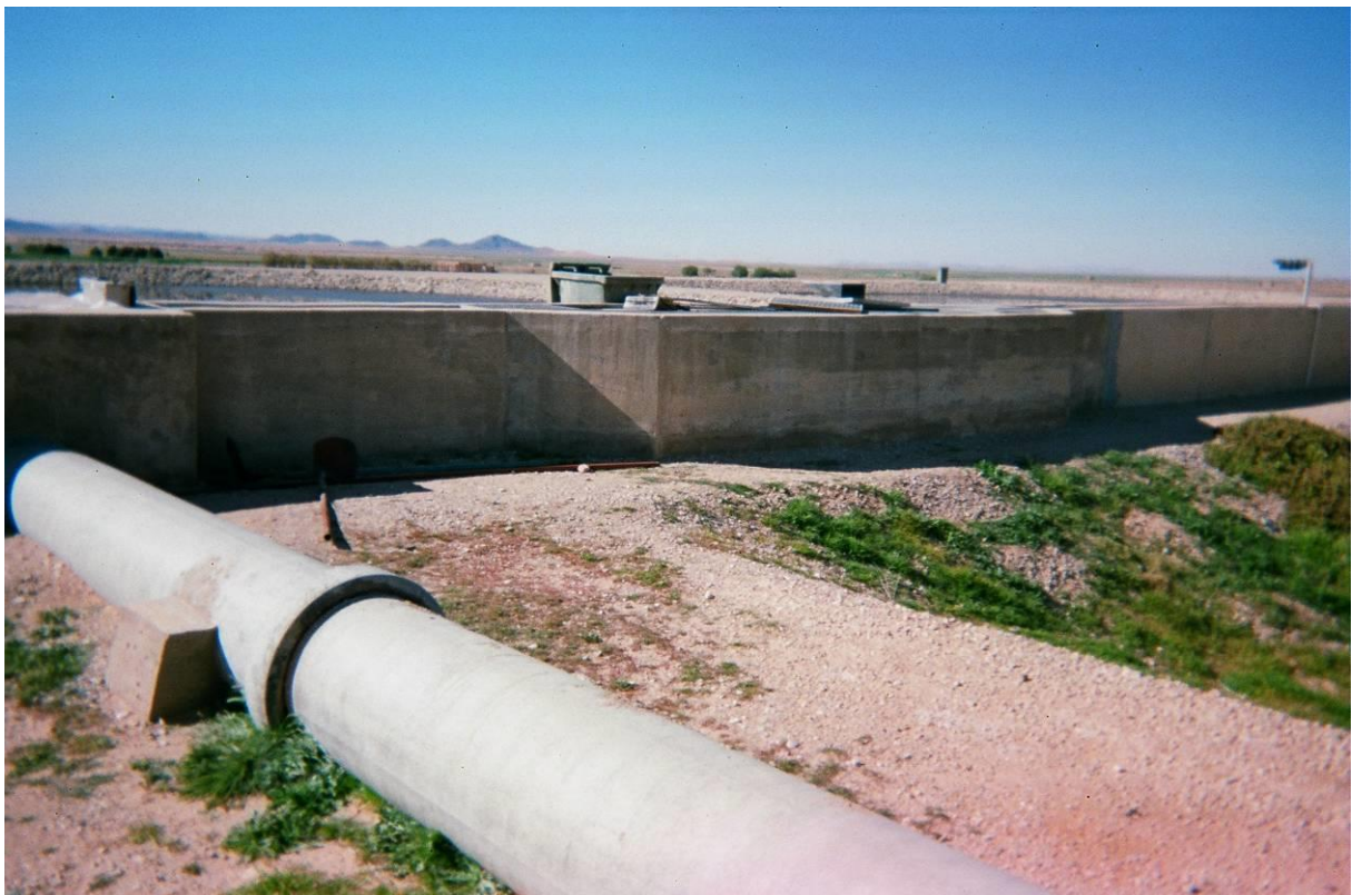
- Photo 7 : Amenée des eaux usées brutes
